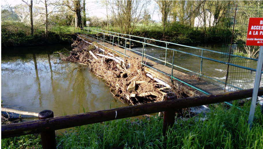
Embâcles accumulés sous un pont. (Photo : DDT41)
