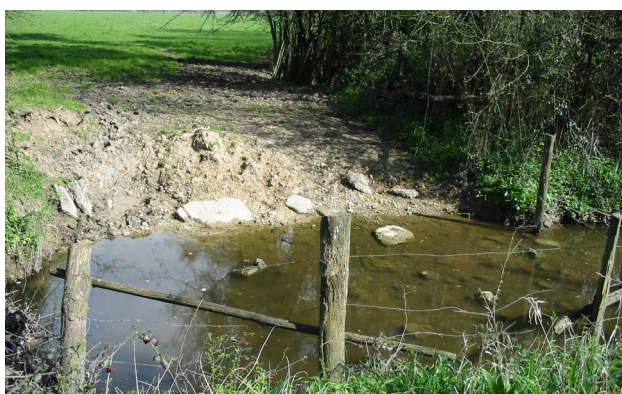
Destruction de berge par le pâturage et installation d'une clôture dans le cours d'eau. (Photo : DDT41)
